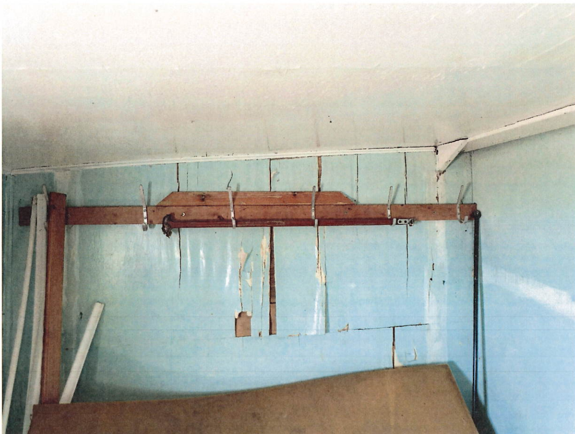
Fot. 51. Podpokład, część dziobowa, zbliżenie na ścianę.
