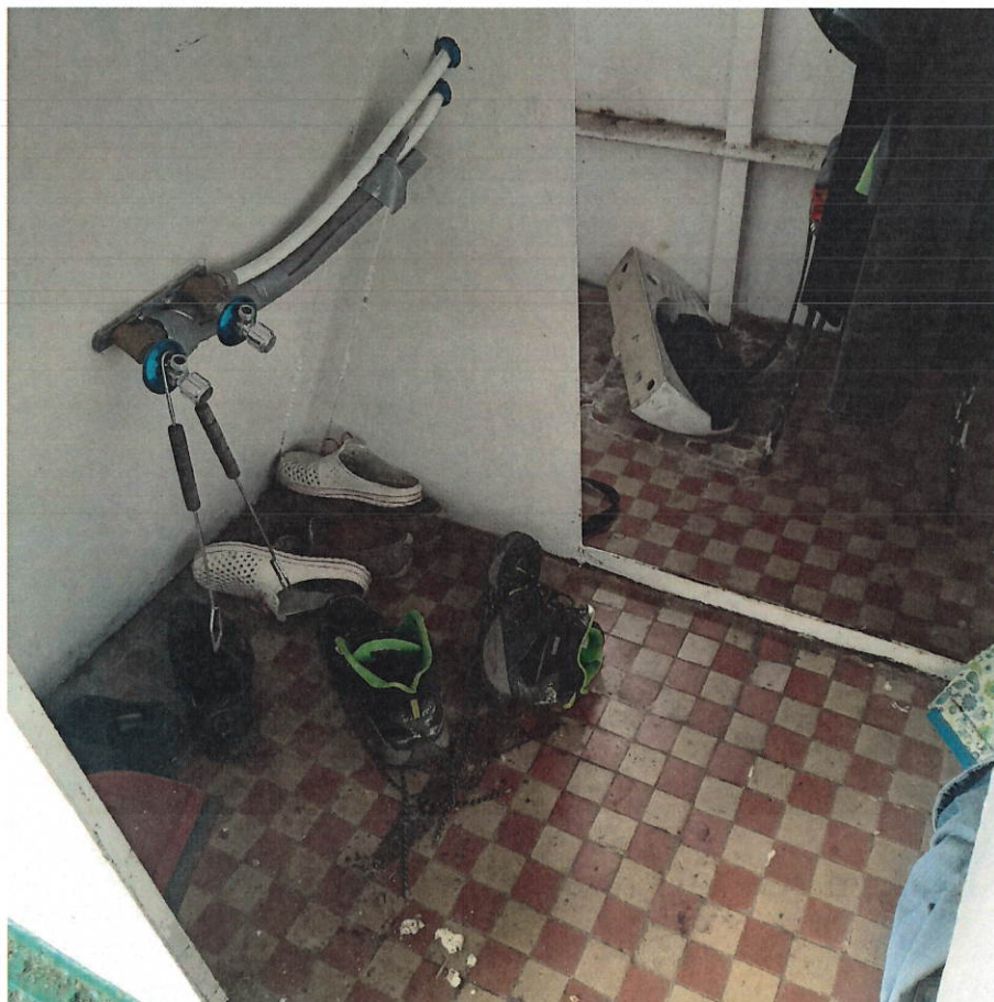
Fot. 73. Sanitariat położony po stronie prawej burty pokładu dolnego, przed wejściem do nadbudówki gdzie ma być umiejscowiona izba pamięci – działający prysznic. Konieczne odnowienie i usunięcie produktów korozji.
