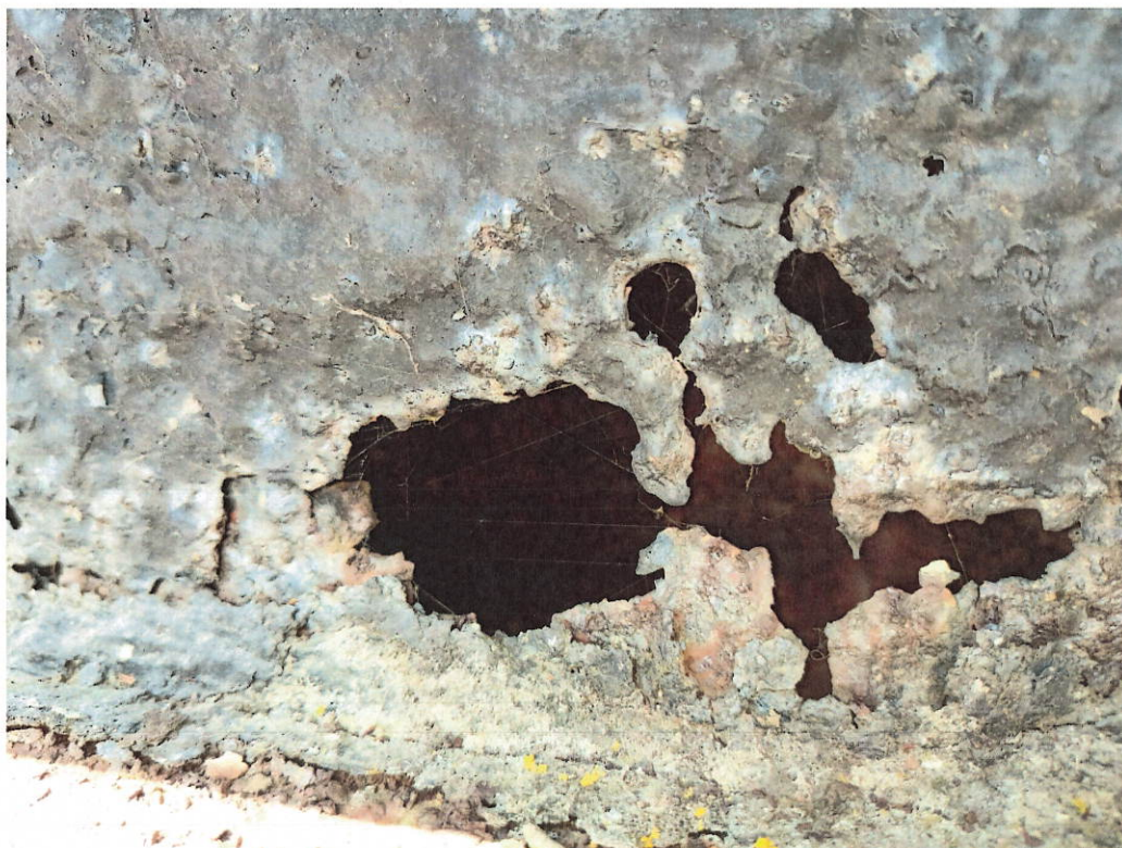
Fot. 28. Zbliżenie na perforacje w dospawanej burcie, spowodowane korozją wżerową.
