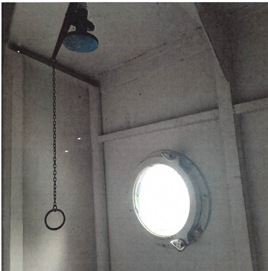
Fot. 74. Sanitariat położony po stronie prawej burty pokładu dolnego, przed wejściem do nadbudówki gdzie ma być umiejscowiona izba pamięci – działający prysznic. Konieczne odnowienie i usunięcie produktów korozji.
