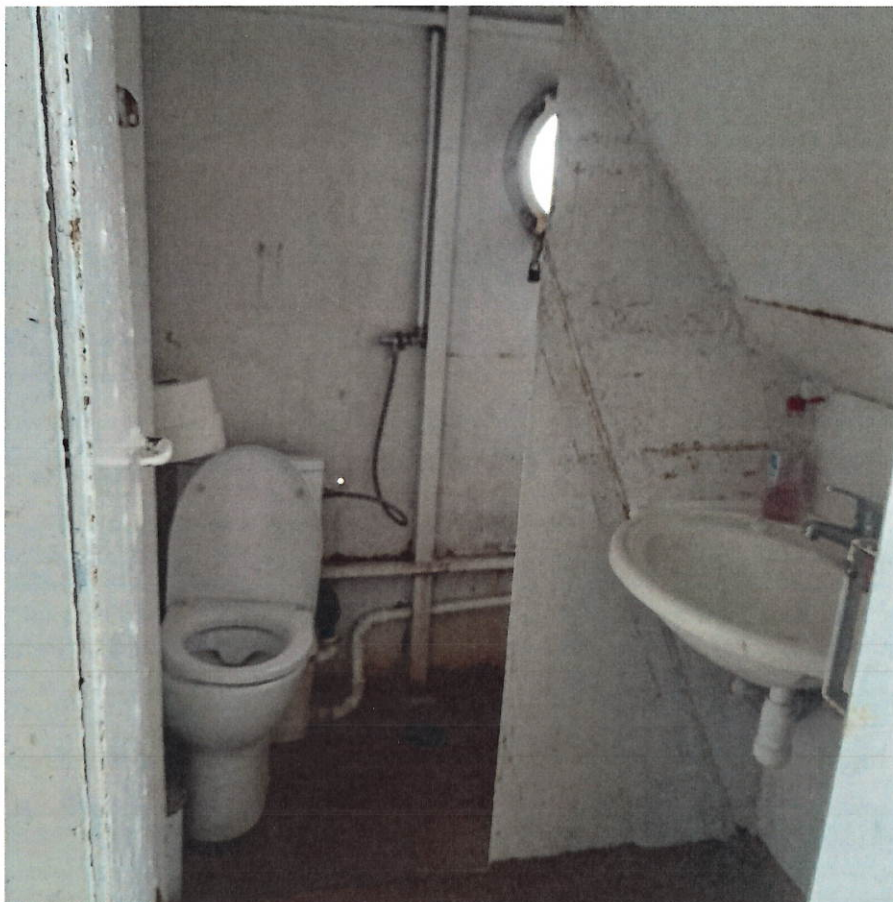
Fot. 72. Sanitariat położony po stronie lewej burty pokładu dolnego, przed wejściem do nadbudówki gdzie ma być umiejscowiona izba pamięci – działający WC. Konieczne odnowienie i usunięcie produktów korozji.
