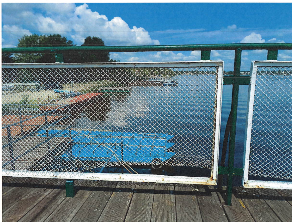
Fot. 37. Górny pokład – barierki, widoczna korozja metalu i uszkodzenia siatki.
