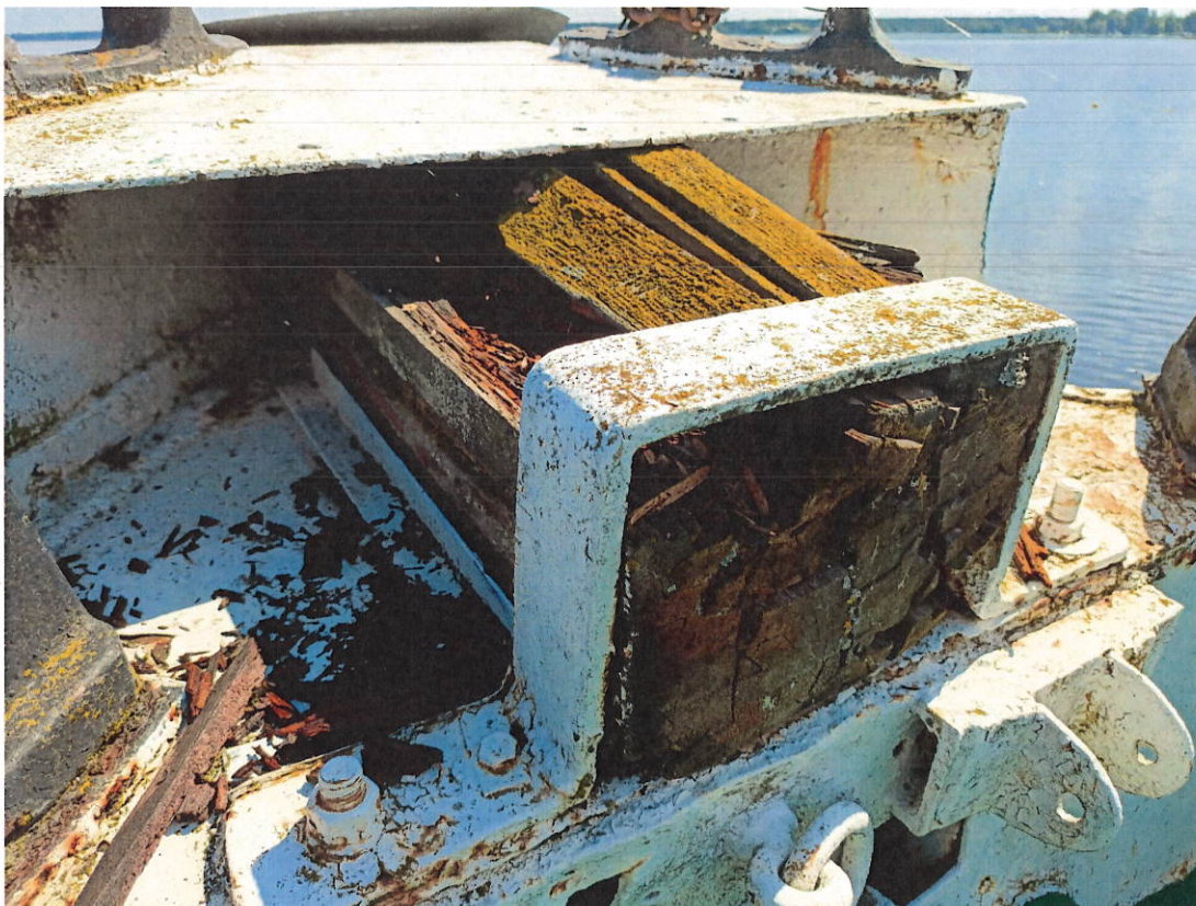
Fot. 35. Bukszpryt zniszczony przez porażenie biologiczne (grzyby i drewnojady) oraz wodę.
