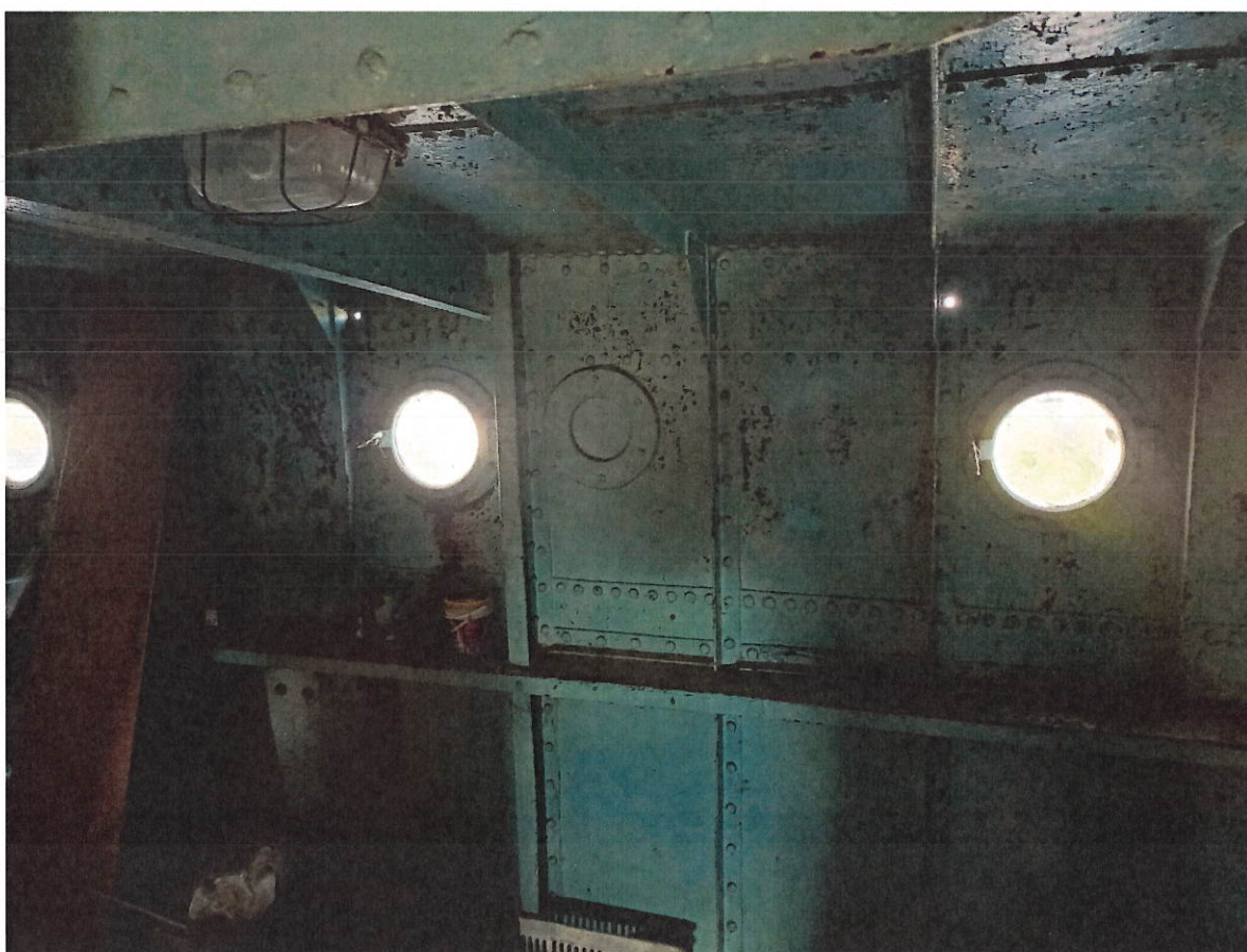
Fot. 45. Część rufowa podpokładu, oryginalna. Widoczne liczne ogniska korozji.
