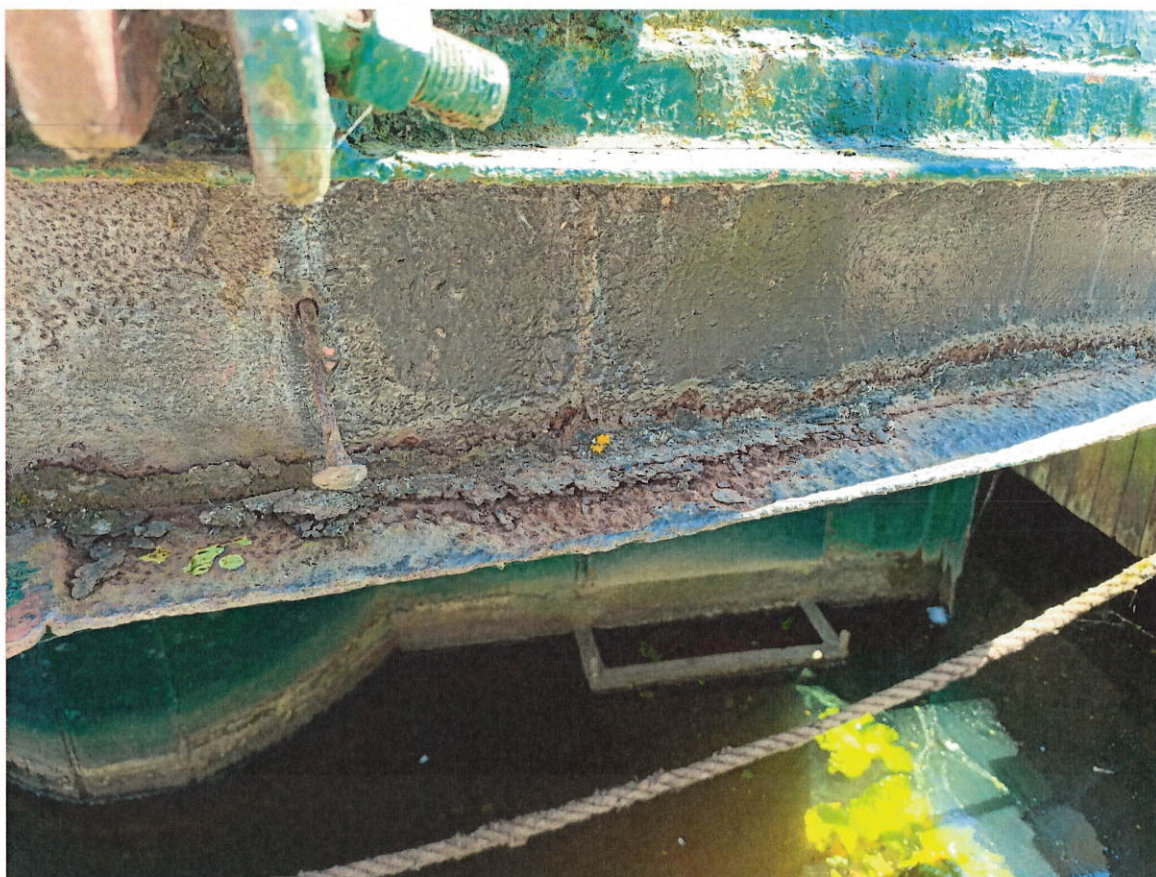
Fot. 31. Rufa ponad powierzchnią wody, stopień uszkodzenia poprzez korozję.
