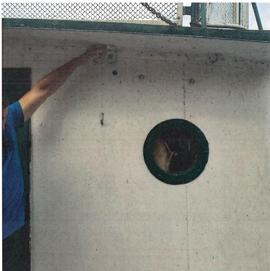
Fot. 71. Ściana rufowa dobudówki z lat 60-tych gdzie ma zostać umiejscowiona izba pamięci, od zewnątrz. Widoczny otwór i przewody elektryczne, które mają zostać wykorzystane do zamontowania urządzenia klimatyzacji.
