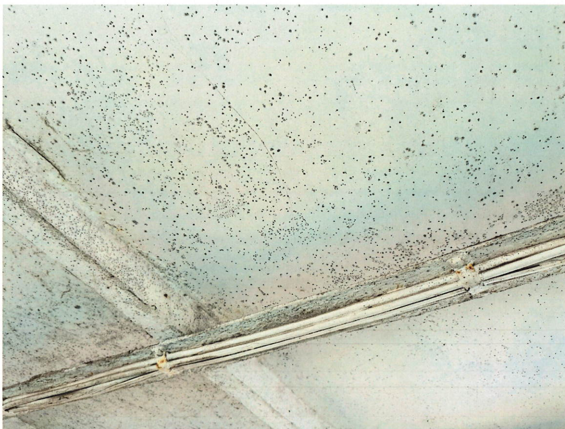
Fot. 38. Kolonie grzybów na suficie pokładu dolnego.
