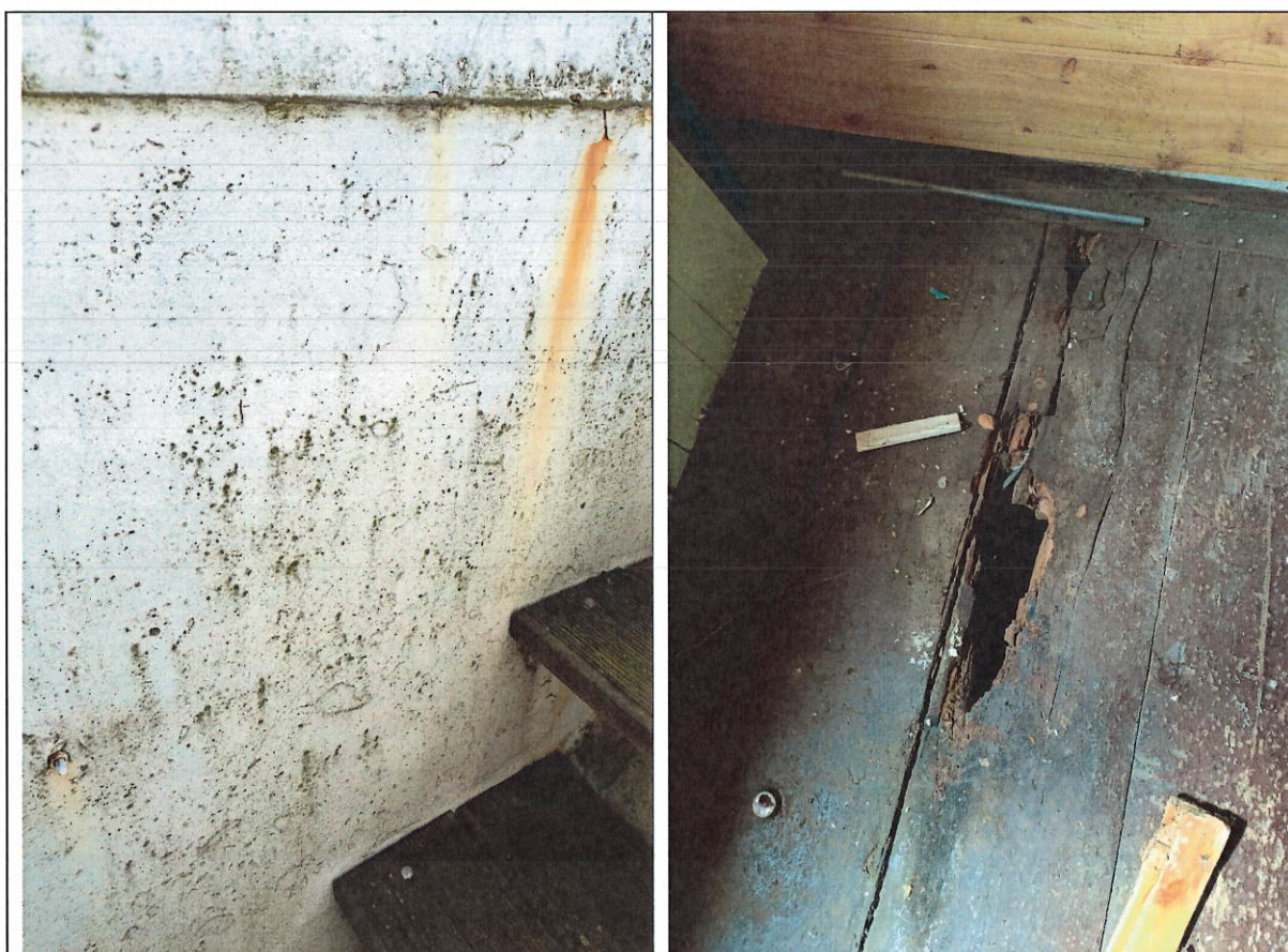
Fot. 39. Zdjęcie po lewej pokazuje wejście z pokładu dolnego na górny w widocznych koloniami grzybów. Fot. 40. Zdjęcie po prawej - uszkodzenie desek podłogi dolnego pokładu.
