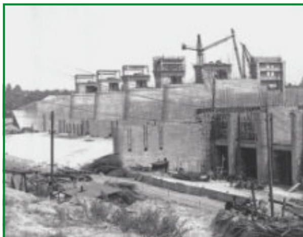
Rys. 5.4. Stopień Dębe w trakcie budowy w 1960 r. – widok od strony wody dolnej (informator CBSiPBW „Hydroprojekt”)
