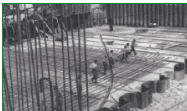
Rys. 5.3. Stopień Dębe w trakcie budowy w 1960 r., układanie zbrojenia płyty fundamentu elektrowni (informator CBSiPBW „Hydroprojekt”)
