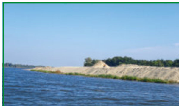
Rys. 5.13. Piasek wydobyty z dna Bugu w ujściu do Jeziora Zegrzyńskiego posłużył do wzmocnienia wałów ochronnych tworząc rozległe plaże
